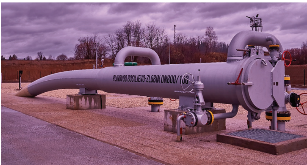
Plinovod Bosiljevo – Zlobin – uporabna dozvola ishoda u rujnu 2025. godine – izgradnjom plinovoda omogućeno je povećanje transporta plina s postojećeg terminala za UPP na otoku Krku s 2,9 na 3,5 milijardi kubnih metara plina godišnje
